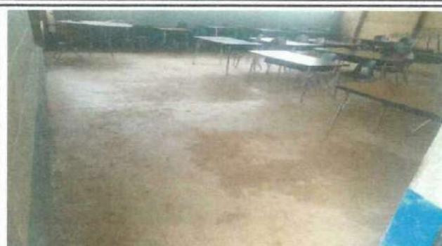
Foto 2: Se observa el deterioro de la torta de concreto en el salón de cuarto primaria, presentando grietas y desgaste en su estructura.
