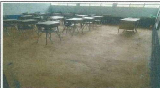
Foto 4: Se observa el deterioro de la torta de concreto en el salón de segundo primaria, presentando grietas y desgaste en su estructura.
